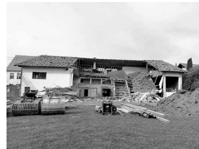
17.08.2022 – am Abend fehlt schon ein großer Teil des Daches
